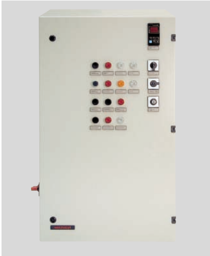
Cuadro eléctrico WS 4/6
