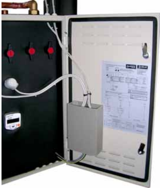
Posición cuadro eléctrico y entradas de cables
