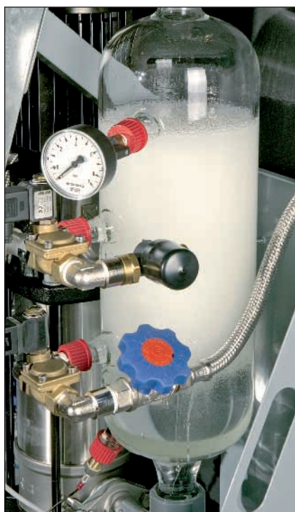
Parte del fluido de la instalación se somete a depresión en el depósito del Superior. Los gases disueltos en el fluido son liberados, separados y eliminados.
